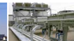
Трансформаторная подстанция Виннипег / Канада
