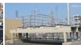
Трансформаторная подстанция Новый Орлеан / США
